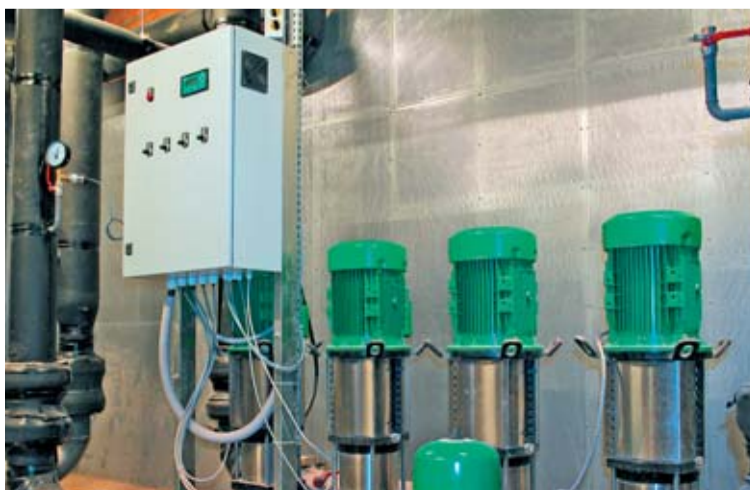
В Національному спортивному комплексі «Олімпійський» реалізовано комплексне інженерне рішення щодо насосного обладнання
